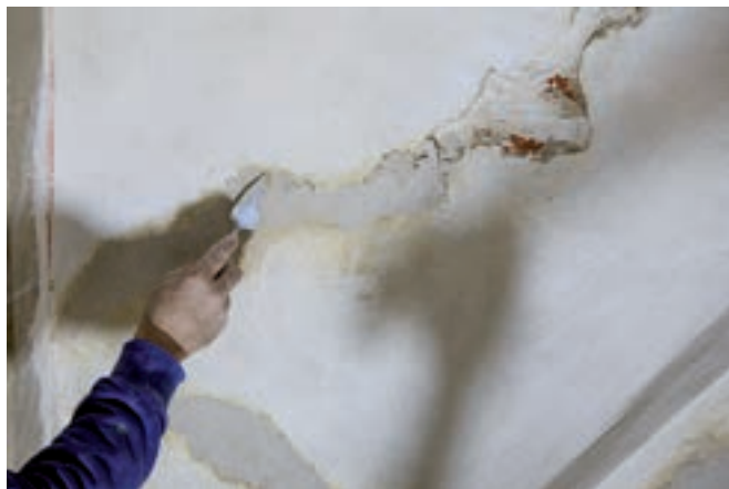
> Aansmeren van scheuren
